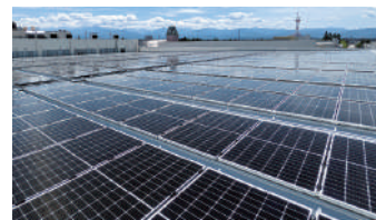
太陽光発電システム (富山事業所に設置)
