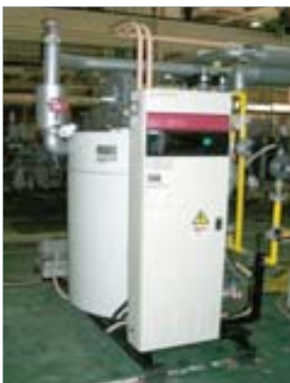
熱媒体油ボイラー (13A LPG ボタン)
