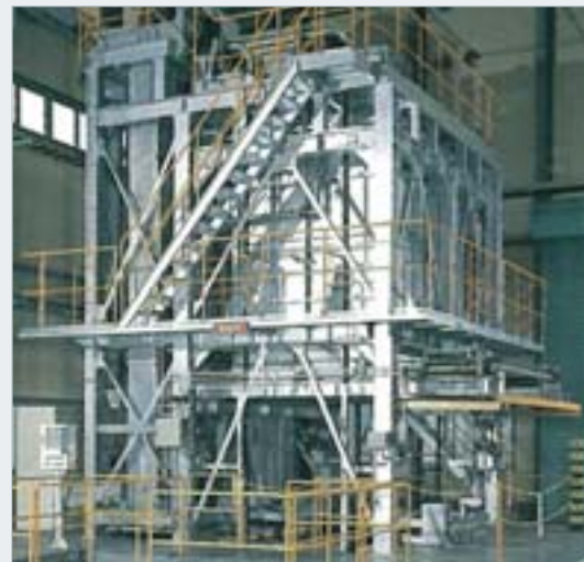
アルミ溶体化炉
